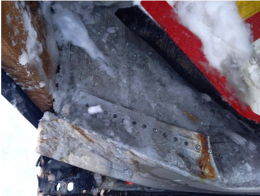
Rückwandtürrahmen unten im Bodenbereich vom Kopfrahmen ausgerissen, verdrückt und deformiert
