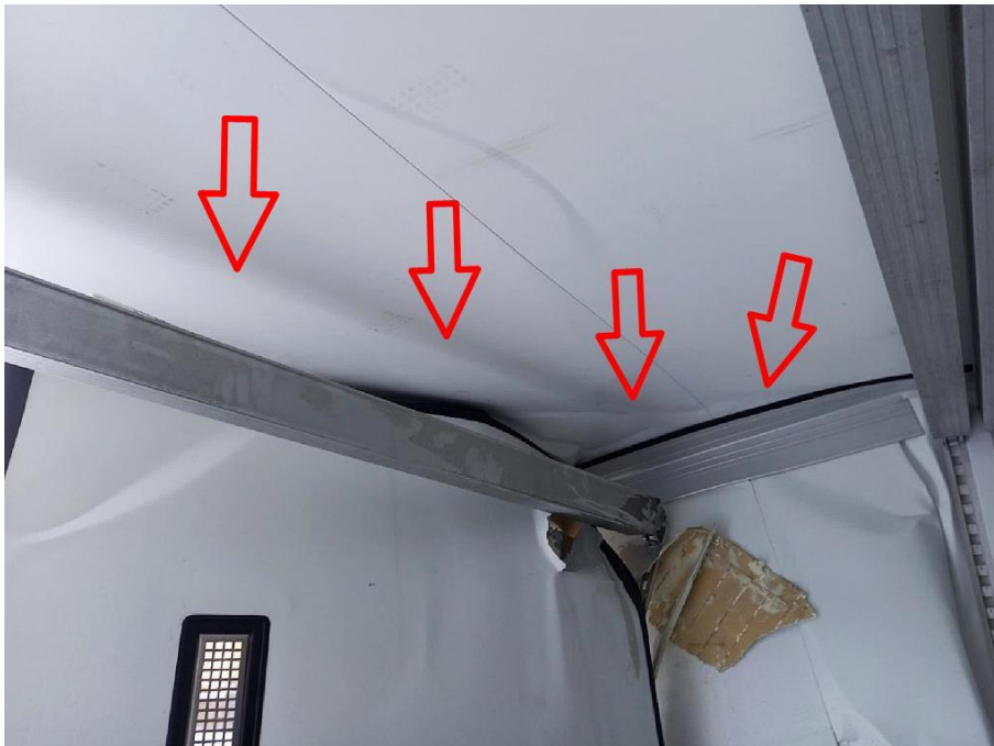
Dachsegmente Nr. 11 und 12 im hinteren Bereich des Kühlkoffers gestaucht und deformiert
