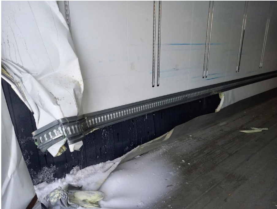
Beschädigungen der linken Seitenwand (Innenansicht)
