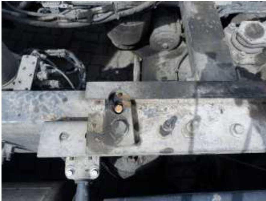
Träger Sattelplatte, Schrauben abgerissen (Archivbild, gleicher Schadenhergang)
